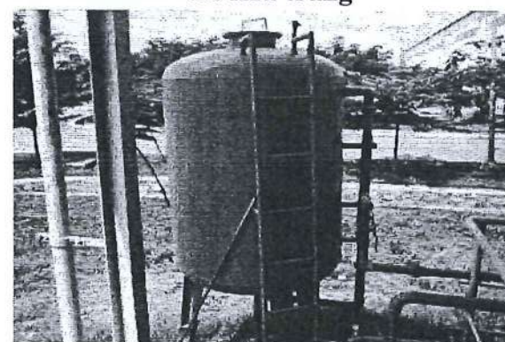
Cột lọc áp lực
