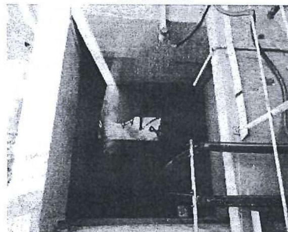
Bể khử trùng
